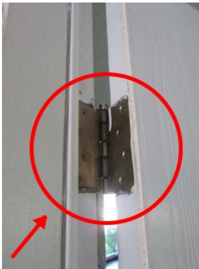
Garage Fire Door
